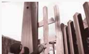
復元西門柱の沈下
