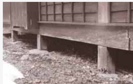
関所資料館土台の老朽化
