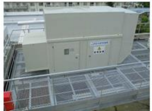
非常電源（自家発電設備）
