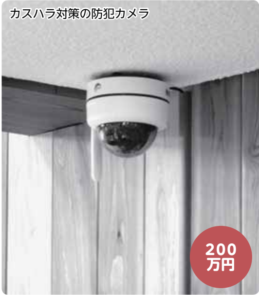
カスハラ対策 防犯カメラ設置
